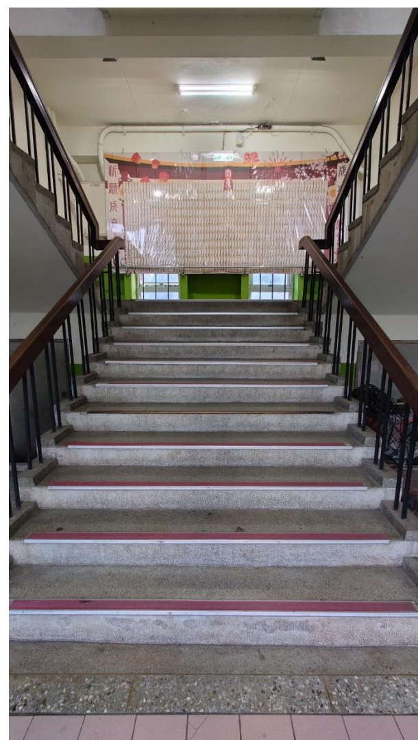
樓梯防滑裝置
